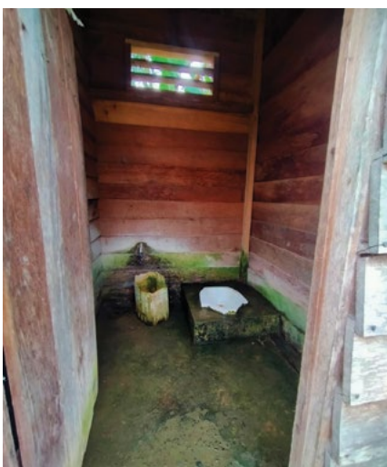
▼ Kondisi toilet para buruh di barak PT Tandan Sawita Papua. Saat ini para buruh mengandalkan air hujan karena perusahaan tidak menyediakan air bersih
